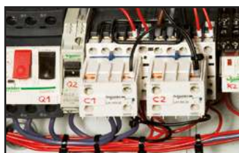
Protector magnetotérmico mediante disyuntores.
