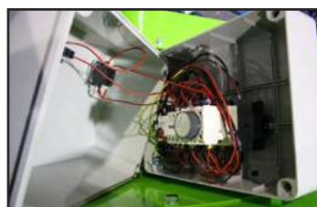
Equipo eléctrico montado en cofre con elevado grado de protección IP657.
