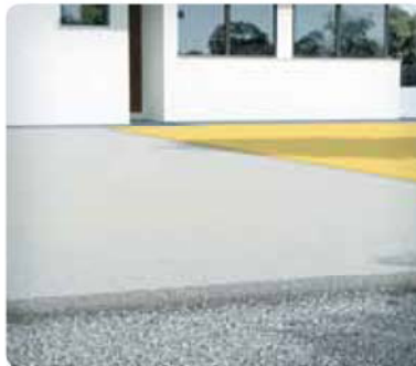
4 Aplicar PAVILAND DRENANTE en un espesor de entre 5 y 7 cm amasando cada saco con 1,75 L de agua, compactando mediante golpeo con llana o regla vibratora (evitar fratar y / o alisar para no tapan el poro). Se realizarán juntas de trabajo, mediante junquillos flexibles o similares, aproximadamente cada 30 m 2 , respetando así mismo las juntas perimetrales y estructurales.
